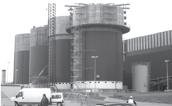
Biogestores donde se obtiene el biogas (gas metano) de la descomposición anaeróbica de materia orgánica.
